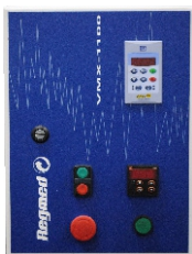
Painel de comando
